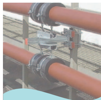
Ochrana potrubí před zamrzáním
