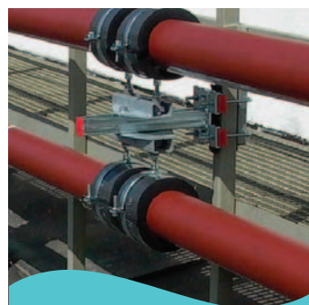
Ochrana potrubí před zamrzáním
